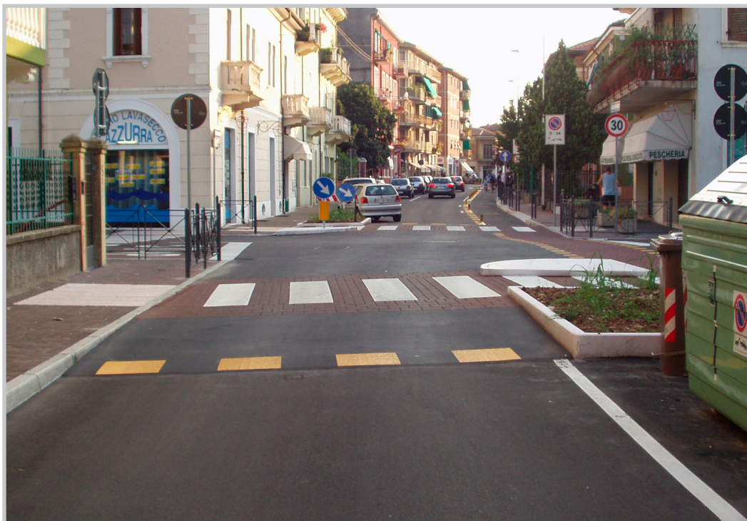
Verona, chicane realizzata con alternanza della sosta e contestuale piattaforma rialzata in bitume
